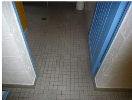
😊 La largeur de ce passage est de 77 cm. Les portes principales desservant des locaux pouvant recevoir moins de 100 personnes peuvent avoir une largeur de passage utile de 0.77m pour les bâtiments existants uniquement
