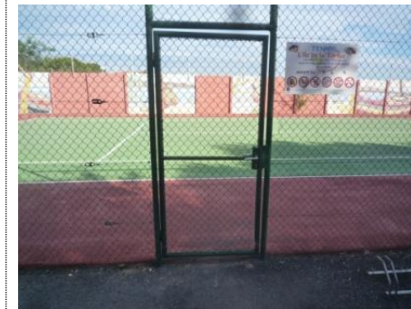
😊 Court de tennis accessible par une porte de largeur 0.90m. A noter cependant le ressaut non conforme qui fera l'objet d'un traitement
