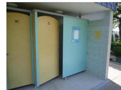
😊 L'aménagement intérieur est conforme. Mais le sens d'ouverture de la porte est à revoir pour garder les espaces de manœuvre suffisants à l'intérieur de la cabine
