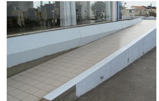
😞 Une rampe d'accès ne doit pas excéder 5% et être accompagnée de palier de repos régulier (espace plan entre 2 pentes). Elle est sinon pénible à la montée et dangereuse à la descente
