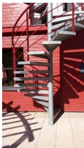
☹ Un tel escalier doit impérativement être matérialisé en dessous (jusqu'à 2.20m) afin qu'une personne mal voyante ou aveugle ne s'y cogne pas
