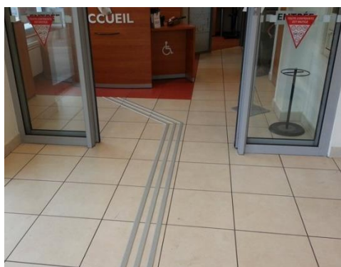
😊 Un comptoir d'accueil situé loin de l'entrée et n'étant pas visible doit faire l'objet d'une bande de guidage (fil d'ariane) pour être repéré plus facilement
