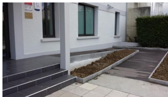
😊 Ces trois marches sont compensées par un plan incliné latéral conforme. En revanche, l'escalier n'est pas totalement conforme : il manque ici la main courante pour franchir les marches, la bande d'éveil à la vigilance avant la descente et les contrastes de couleur sur la première et la dernière contremarche
