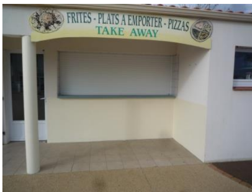
⊗ Comptoir du snack : absence de partie surbaissée qui s'applique pourtant à tout point de vente
