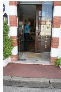
😞 Ici, le sas est trop exigü, le trottoir infranchissable et la largeur de la seconde porte trop étroite également. C'est la totalité de l'établissement qui est à revoir ou doit faire l'objet d'une demande de dérogation selon les circonstances
