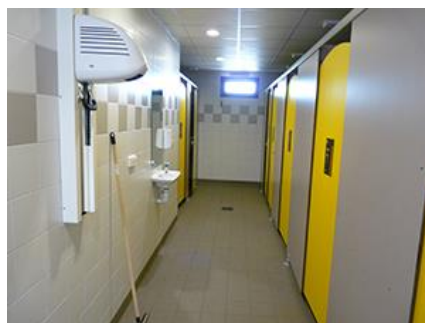
☹ Le sèche-cheveux représente un obstacle en saillie dans le cheminement qu'il faudra signaler ou supprimer
