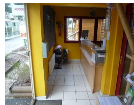
☹️ Sans aire de rotation, impossible de faire ½ tour une fois entré dans l'espace d'accueil. (A noter : le comptoir d'accueil ne propose pas de partie surbaissée)
