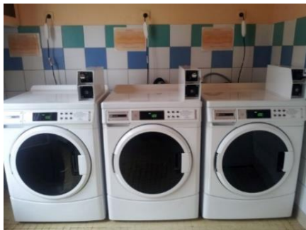
😊 Ces machines répondent aux critères d'accessibilité : chargement frontal et accessibilité des monnayeurs
